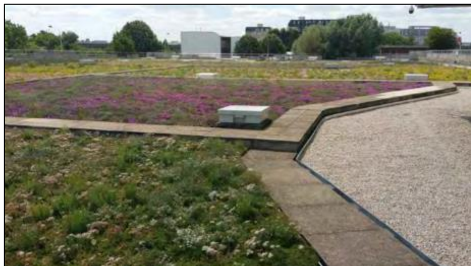
Figure 44 : Toiture végétalisée (Flexirub)
